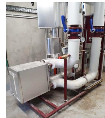
Sous-stations (point de livraison à l'abonné)
